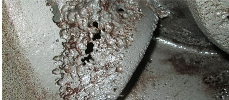
Kavitasjonsskader på en pumpe
